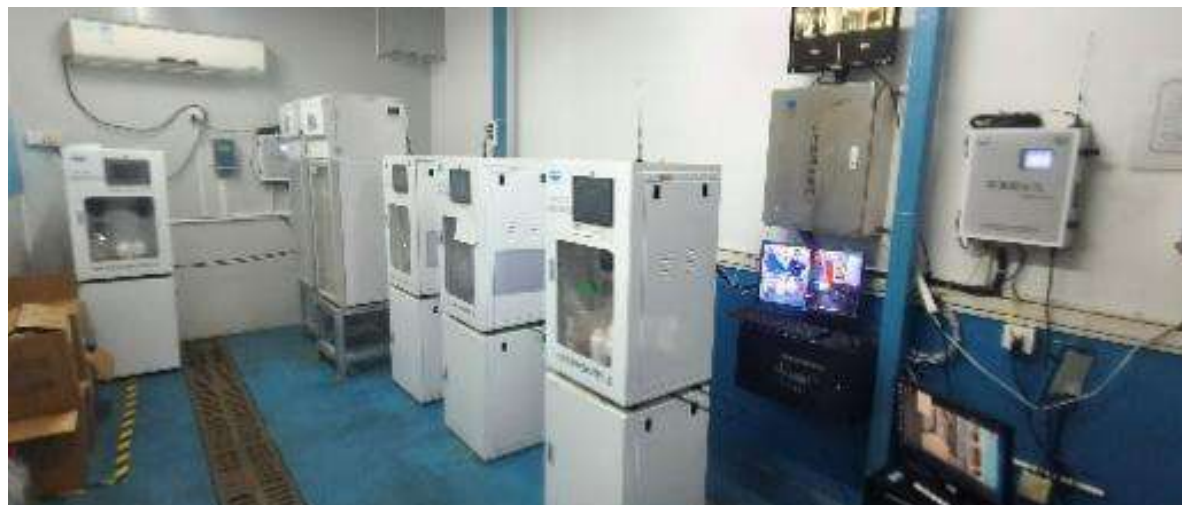
廢(汙)水監測設備
