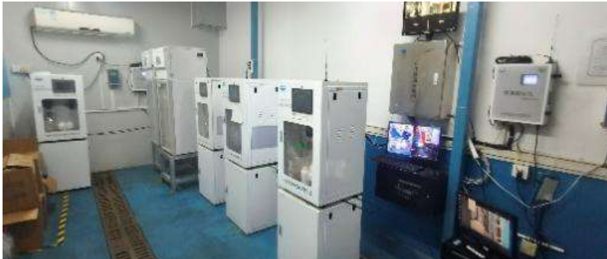
廢（汙）水監測設備
